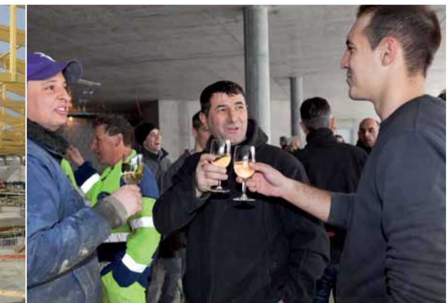
Aufrichte, März 2013 27. März 2013 – und vom Frühling keine Spur! Trotzdem feiern 120 Bauleute die Aufrichte. Sie wärmen sich mit Bratwurst, heissem Risotto und einem guten Glas Wein den Bauch und das Herz.
